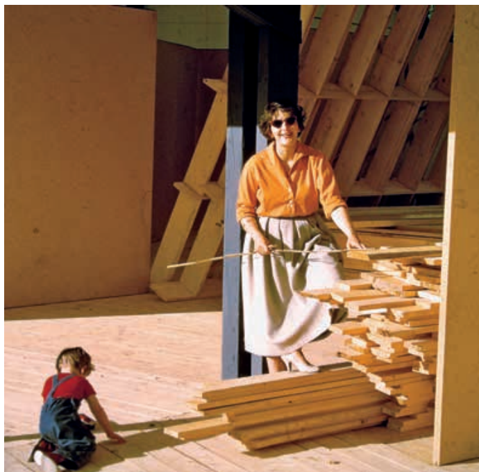
Verena Fuhrmann-Weber mit Sohn auf der Baustelle der SAFFA 1958 (Privatarchiv Familie Fuhrmann, Zürich)
