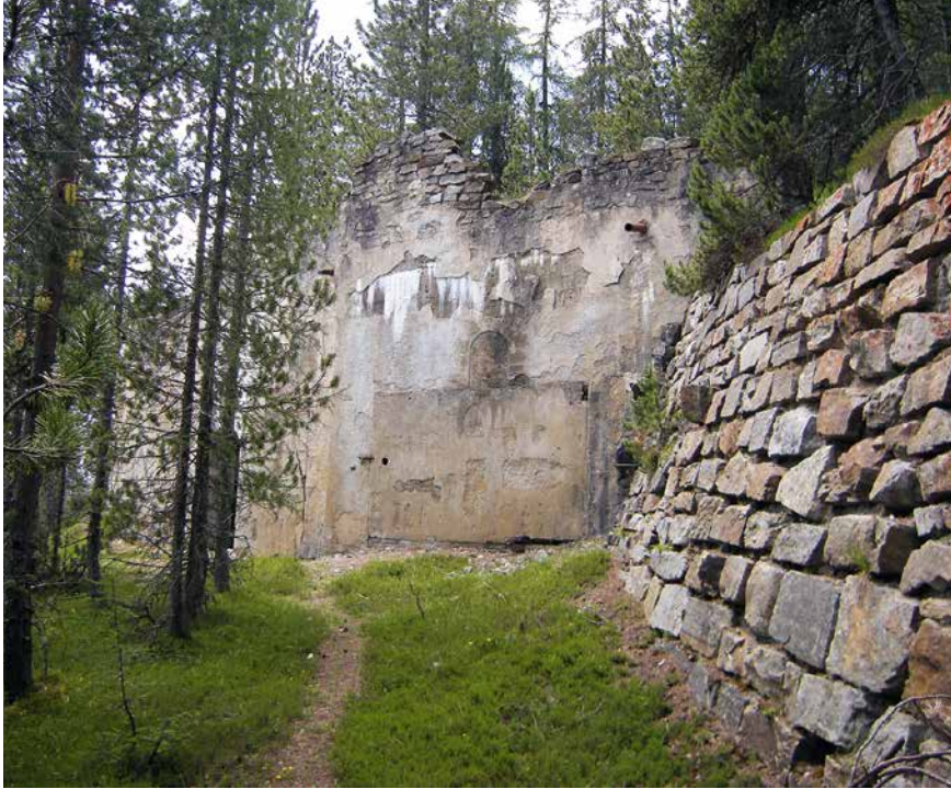
Abb. 8 Der Infanteriebunker Ova Spin GR. Vor die Scharfenfront des Bunkers wurde in Manier einer Theaterkulisse eine Burgmauerstruktur auf Rabitz aufgetragen. Foto ADAB-Inventar, Thomas Bitterli
