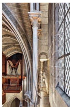
Fig. 15a-15b Coursière haute de la septième travée depuis la croisée, l'amorce d'une couverture en arc a été abandonnée au profit d'une couverture en dalles. Photo Archéotech SA, 2024
