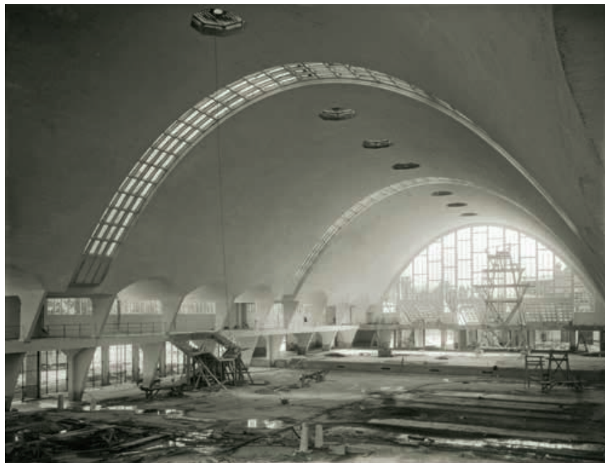
Fig.17 La halle de Reims en chantier, 1927. Photo Henri Deneux, Bibliothèque Carnegie Reims
