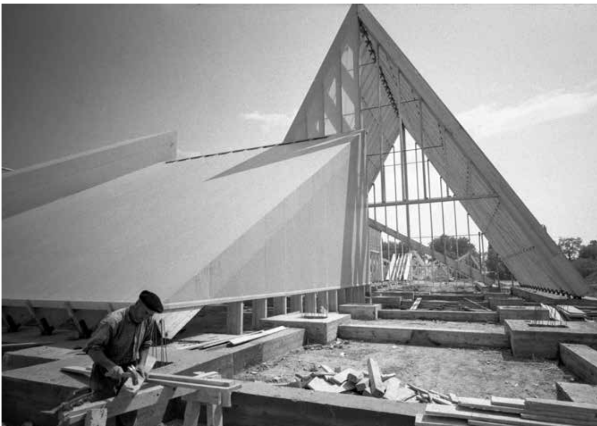
Sektor «Weg der Schweiz» im Bau, 1963. Konstruktion mit verleimten und genagelten Holzbalken und Metallgelenken, die zu dreieckigen Mehrfachbindern verbunden wurden (Bildarchiv ETH-Bibliothek Zürich)
