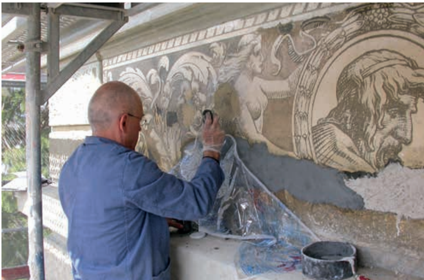
Abb. 12a/b Um die Sgraffiti dauerhafter zu sichern, wurden die Oberflächen 2003 mit Kieselsäure-ester hinterspritzt und zusätzlich mit der Schnabelflasche geflutet. Fehlstellen wie bei diesem Porträtmedaillon auf der Hauptfassade wurden mit grau gefärbtem Kalkmörtel ergänzt. © Kantonale Denkmalpflege Aargau, ZOF068-BE-2003-01/005, Bericht von Heinz Schwarz und Gertrud Fehring, 2005, Bild Nr.94 (oben) und Bild Nr.106 (unten)
